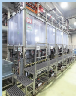
精密洗浄事業 酸剥離設備
