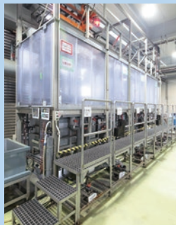
精密洗浄事業 酸剥離設備
