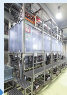
精密洗浄事業 酸剥離設備
