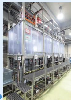
精密洗浄事業 酸剥離設備
